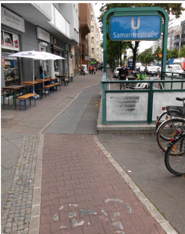
Problematisches Aufeinandertreffen für Radfahrer und Fußgänger, hier auf einem Teilabschnitt der sonst sehr belebten Frankfurter Allee.
